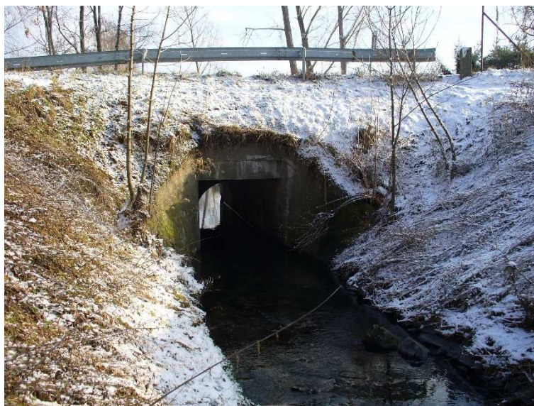
obr. 11 – úsek 05, pohled po proudu na objekt č. 5, ulice Bělomlýnská, navržený k rekonstrukci
