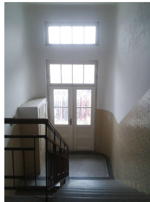
Rozvaděče elektro na podestě schodiště
