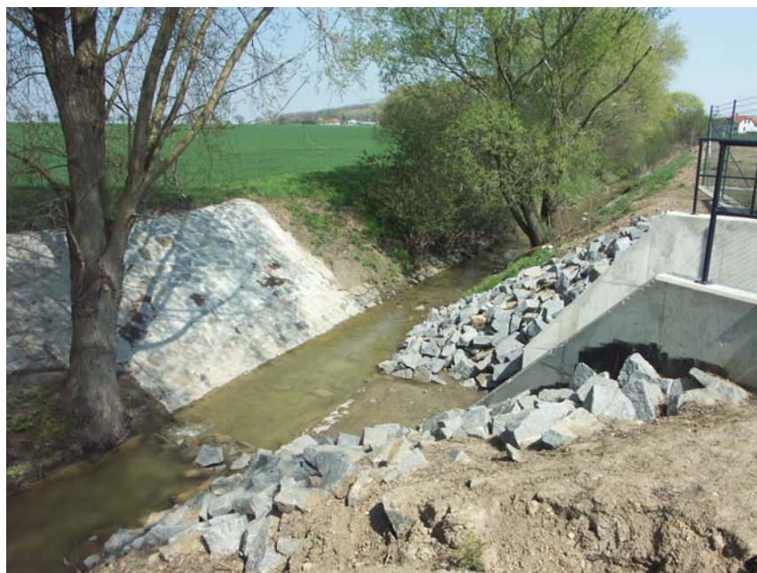
Obr. 9.18 Výúst' z vírového separátoru v ř. km 11,465
