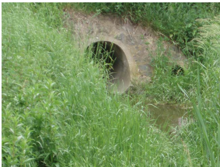
Obr. 8.3 Výtok do recipientu u ul Chřibská
