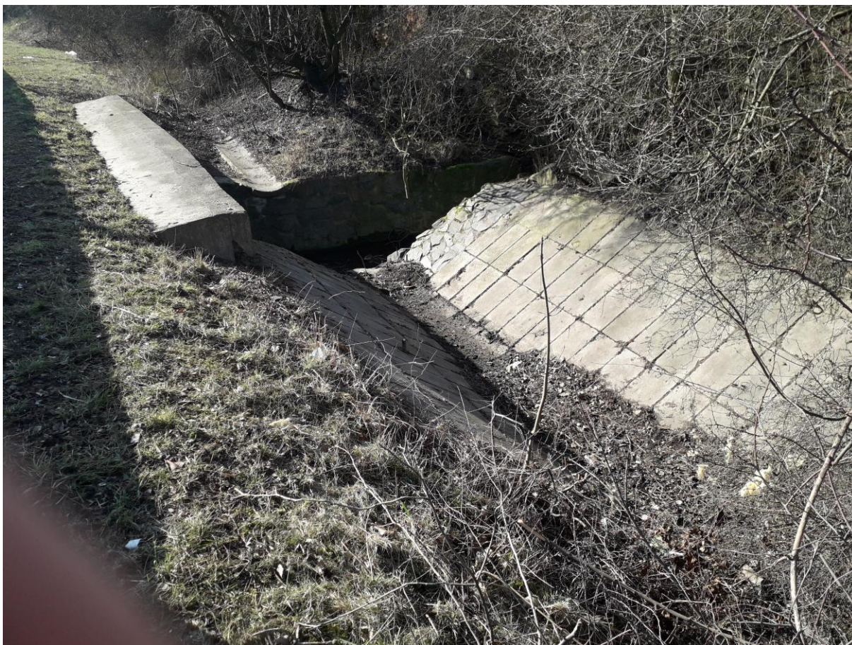
Obr.č. 17 foto –Mratínský potok – vtok do propustku DN 1700 pod Ďáblickou ulicí
