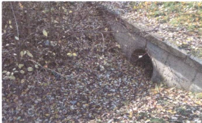
suchý výtok z podloží skládky 2018 - 2020
