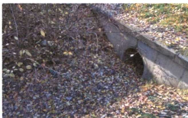
suchý výtok z podloží skládky 2018 - 2021
