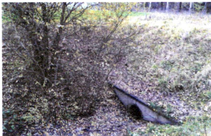
slabě zvodnělý suchý výtok z podloží skládky, stav 11/2022
