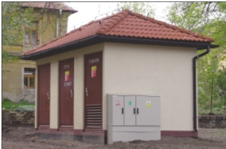
Nová trafostanice PRE v ulici U parkánu.
