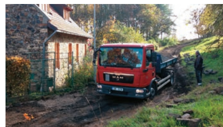
Předzvěst objeveného průsaku z vodovodního řádu – měkké podloží v místech, kde voda neměla být.
